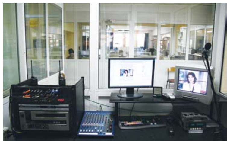
Ένας ακόμη σταθμός Editing στις εγκαταστάσεις της TRT στον Βόλο
